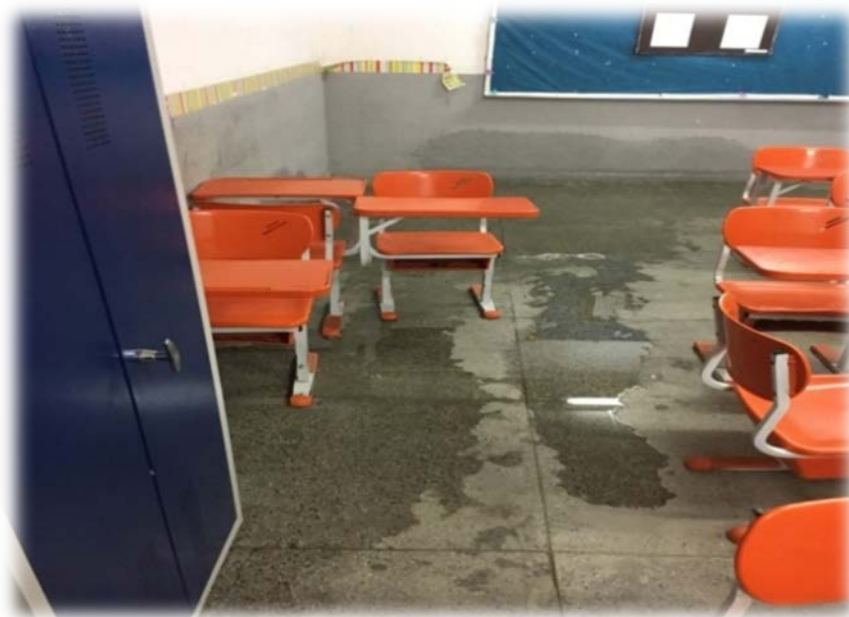
Figura 11 - Vazamento de água da chuva e infiltrações nas salas de aula da escola
